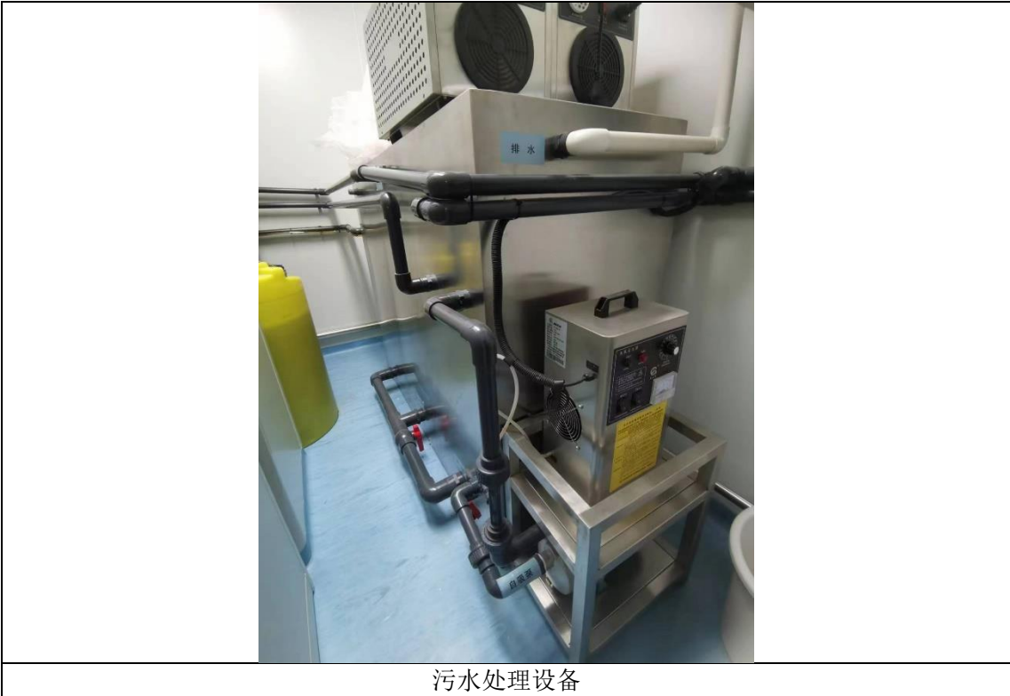
图 4.1-1 污水处理设备照片
